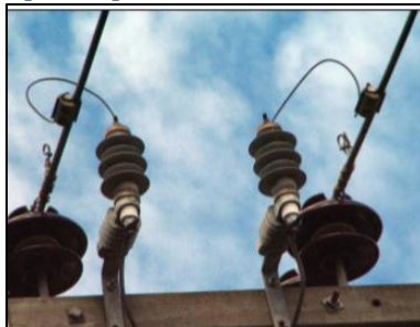
Figura 6 – Instalação típica de para-raios ZnO.
