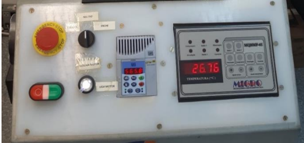
Figura A.1- Controles da bancada para partida/parada do circuito de água, controle de vazão e temperatura.
