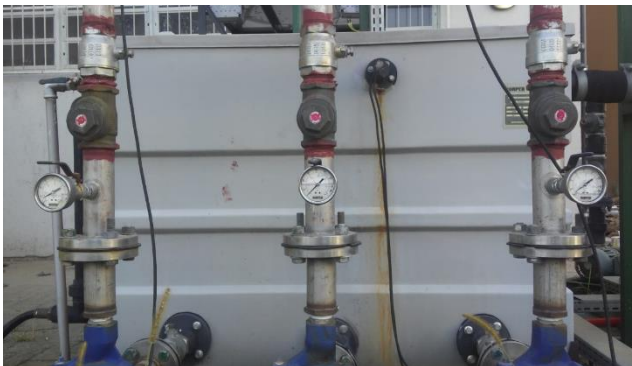
Figura50– Manômetros e reservatório da torre de arrefecimento.
