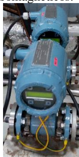
Figura 46– Medidores de vazão eletromagnéticos.
