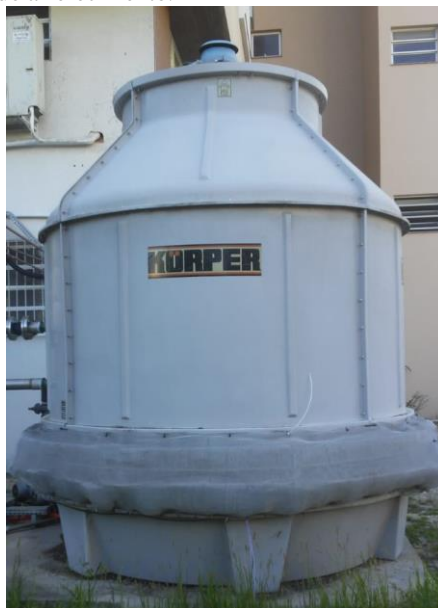
Figura 51– Torre de arrefecimento.
