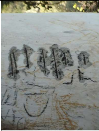
Armadura exposta no pilar
