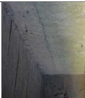
Fissura em linha a 45° nos cantos na viga 7
