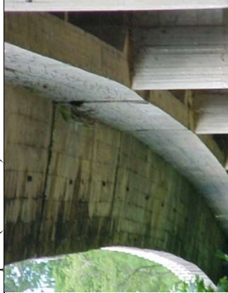
Ausência de pingadeiras e fissuras nas lajes em balanço
