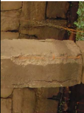
Destaque para defeitos no pilar
