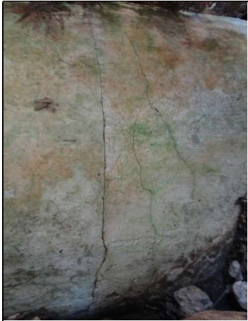
Fissuras no Pilar
