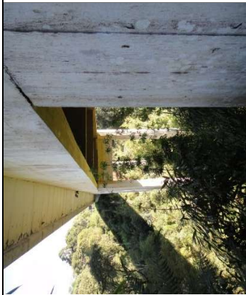
Ausência de acostamento
