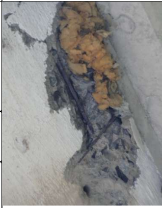
Desagregação do concreto com armadura exposta na laje
