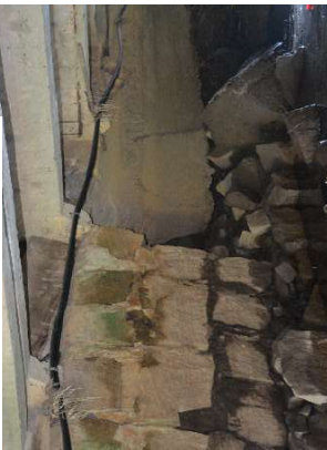
Descolamento no encontro de pedras 1
