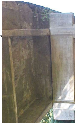
Armaduras expostas nas transversinas, nos pilares e nas vigas de travamento dos pilares. Infiltração nas cortinas.
