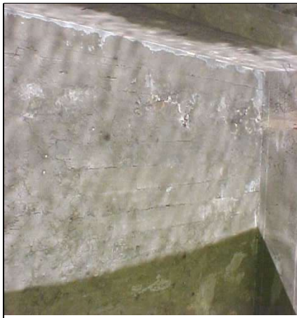
Fissuras e efflorescência na laje
