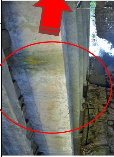
Fissura em linha no meio do vão da viga 8
