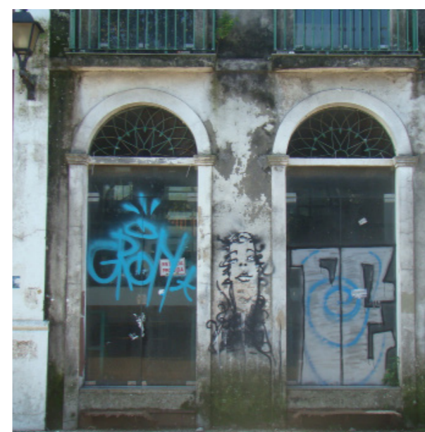
Imagem 06: situação de degradação e abandono comum em edificações nos centros históricos fonte: arquivo pessoal
