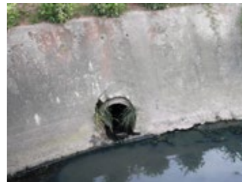
Tubulação que desemboca no rio, próxima à Igreja Matriz de Campinas. Fonte: Acervo pessoal.
