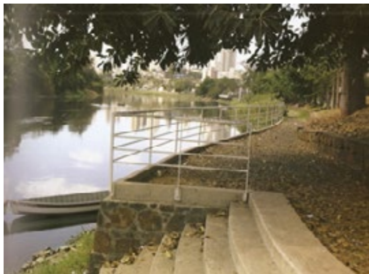
Substituição de estruturas nas margens do rio. Fonte: Rios e Cidades, Ruptura e Reconciliação. GORSKI, Maria Cecília Barbieri. Págs. 200-201.
