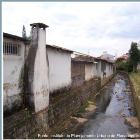
Deficiências no sistema de esgoto da região
