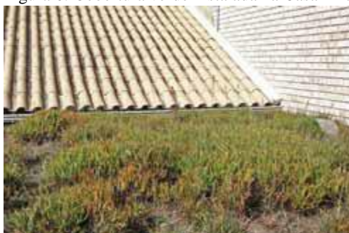
Figura 6: Cobertura verde instalada na Casa Eficiente, Florianópolis-SC.
