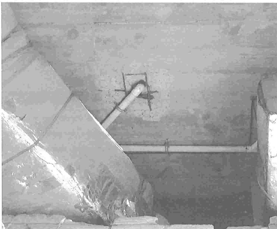
Figura 1 - Detalhe do furo na laje do segundo pavimento
