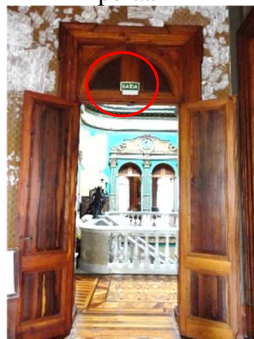
Figura 33 - Sinalização de abandono e luminária de emergência sobre a porta.
