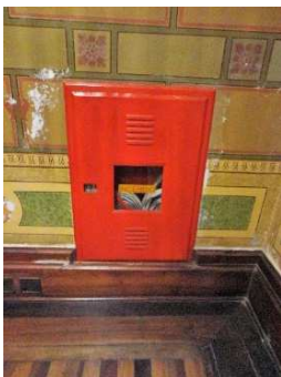
Figura 31 - Abrigo de mangueiras de incêndio.
