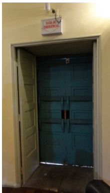
Figura 50 - Porta travada da Saída 4.
