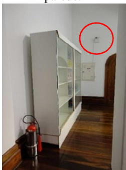
Figura 32 - Extintor de piso e, ao fundo, luminária de emergência fixada na parede.
