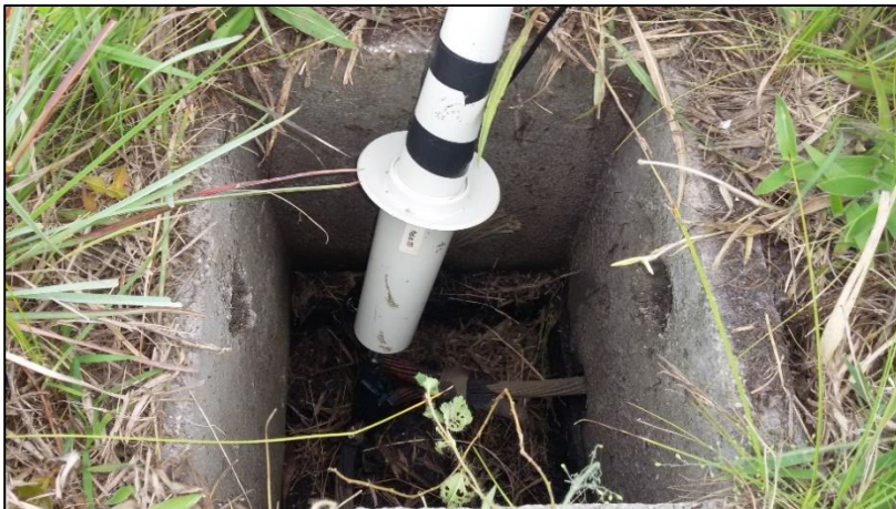
Figura 25 – Ponteira de alta tensão conectada diretamente na malha de aterramento
