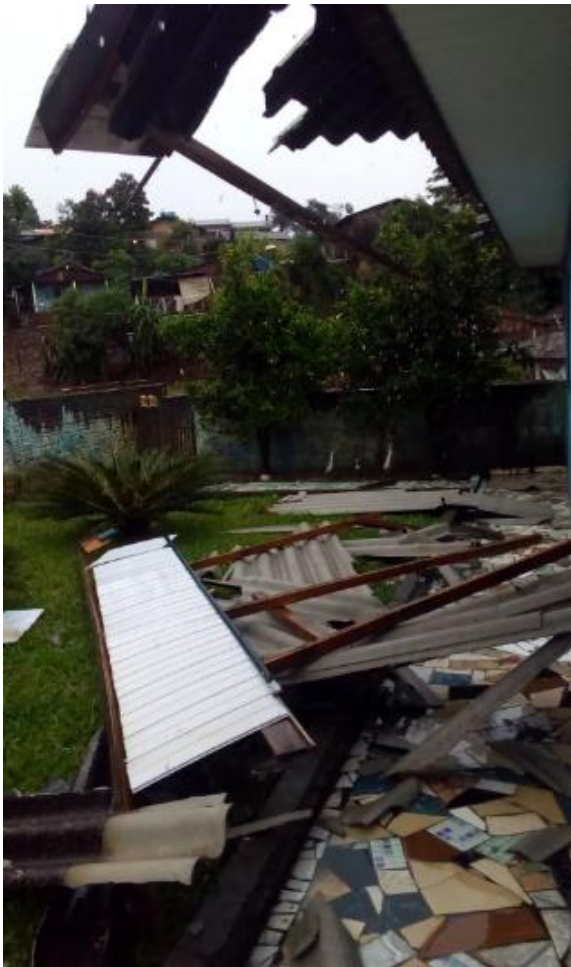
Casa destelhada em Xaxim Foto: Defesa Civil/ Divulgação
