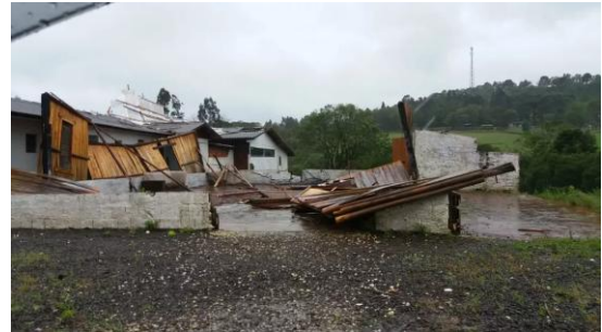
Casa prejudicada em Ponte Serrada Foto: Defesa Civil/Divulgação
