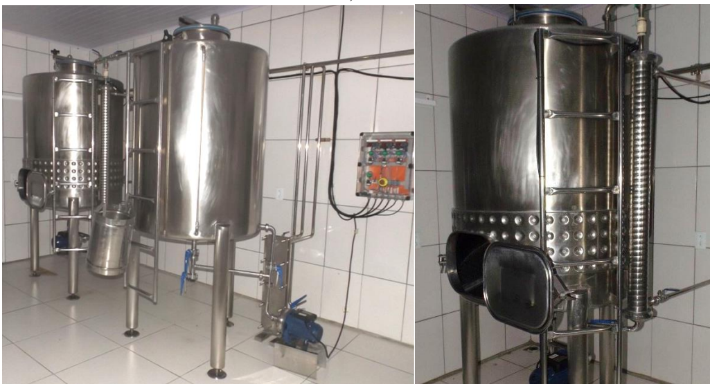
Figura 8 – Tanques de processo e trocador de calor, à esquerda; taque 1 e termomacerador tubular, a direita
