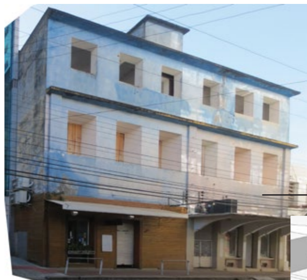
Edifício Abandonado FONTE: Acervo Pessoal
