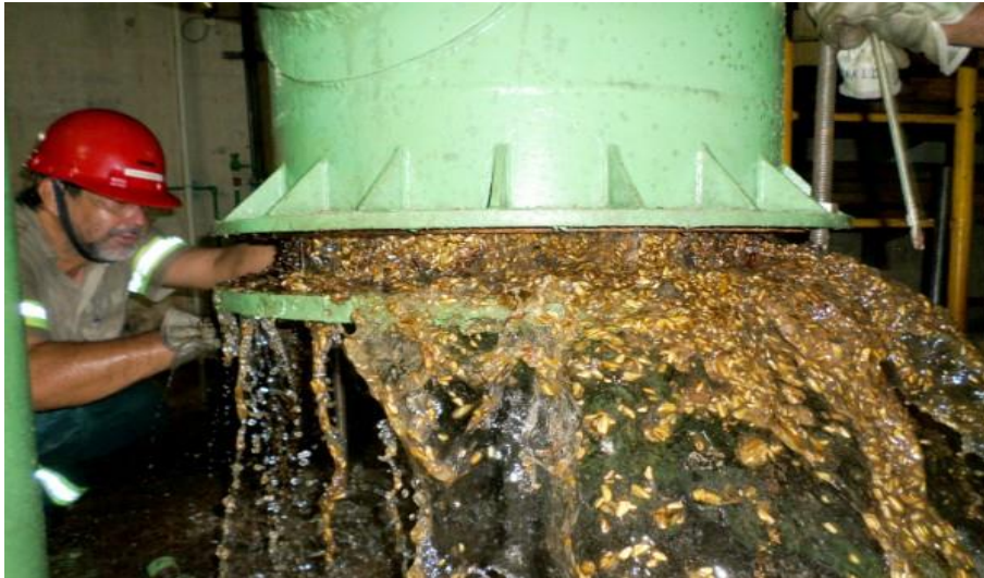
Figura 8 – Tubulação obstruída pelo mexilhão-dourado.
