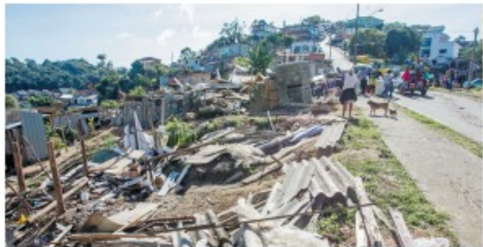
Parte do material dos barracos demolidos foi deixado no local para servir de exemplo a futuros invasores
