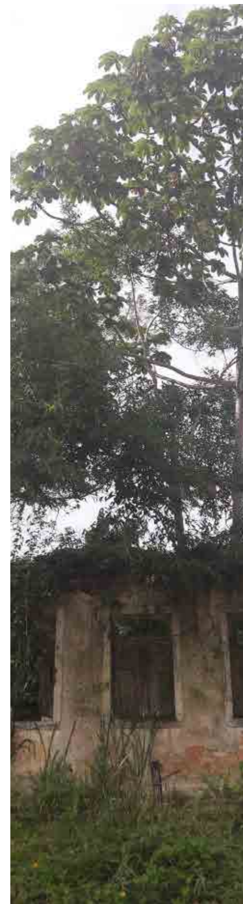
Edificação abandonada pertencente às propriedades da Usina do Maruim considerada Patrimônio tombado pelo município.
