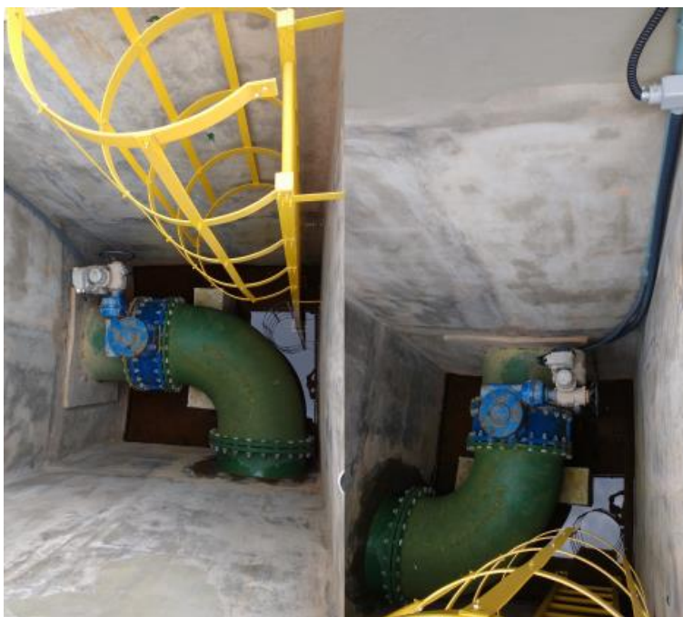
Figura 46 – Tubulação antes e depois.
