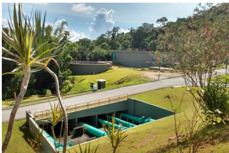
Figura 1 – Tanque de equalização ao fundo.
