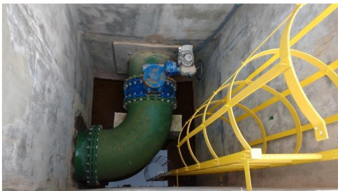
Figura 5 – Válvula com atuador elétrico na entrada do tanque.
