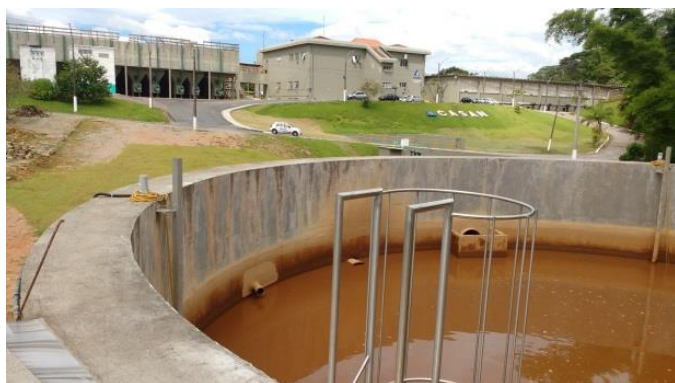
Figura 4 – Tanque de Equalização.
