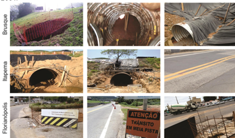
Figura 1 – Problemas com escavação manual em Santa Catarina entre 2012 e 2014.
