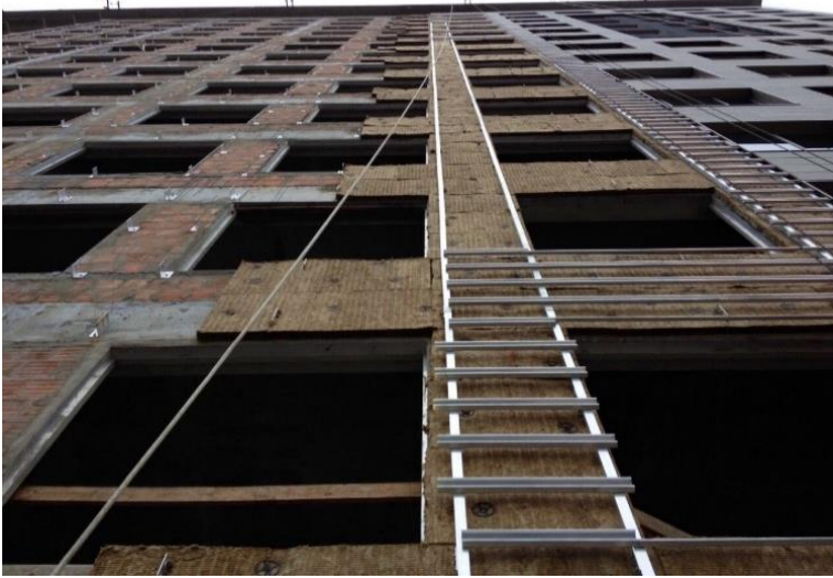
Figura 85 - Execução da fachada industrializada do estudo de caso B. a) Fixação das cantoneiras, revestimento térmico e perfis metálicos.
