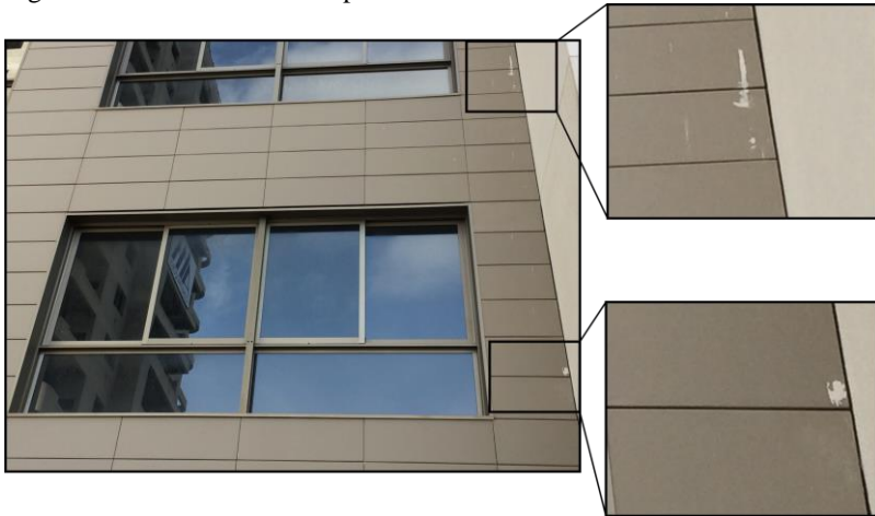
Figura 98 - Manchas de tintas provenientes do volume de escadas de incêndio.
