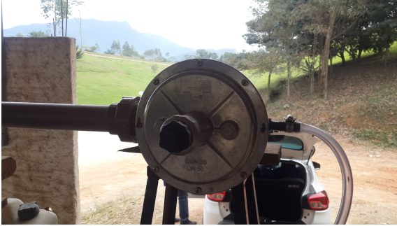
Figura 17 – Válvula redutora de pressão.
