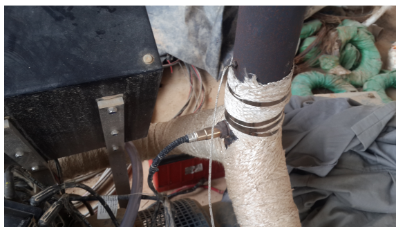
Figura 25 – Termopar na saída dos gases de exaustão do motor para medir a temperatura de exaustão.
