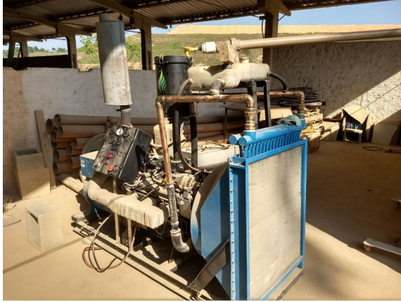
Figura 12 – Motogerador do LabCET/UFSC instalado no aterro de Brusque.
