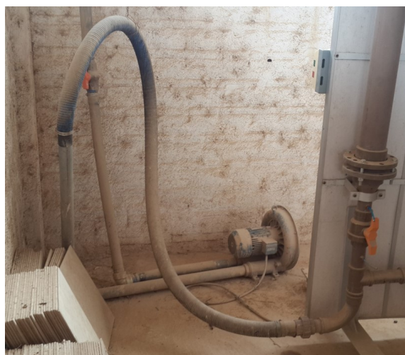
Figura 16 – Compressor instalado antes do painel de purificação.
