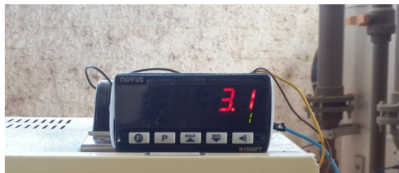
Figura 21 – Indicador de velocidade do biogás.
