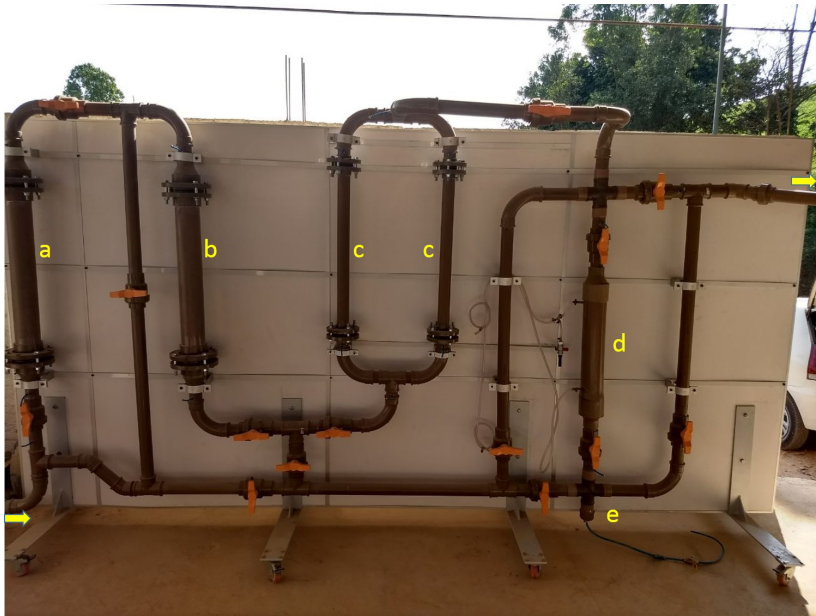
Figura 14 – Painel purificador do biogás através do uso do carvão ativado. Na imagem tem-se a primeira coluna com carvão ativado (a); a segunda coluna (b); a terceira passagem para filtragem através de duas colunas em paralelo (c); o desumidificador (d); e o dreno de umidade (e). As setas indicam a região de entrada e saída do biogás, assim como o sentido do escoamento.
