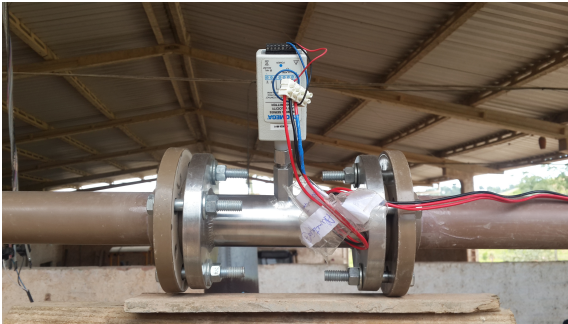
Figura 20 – Medidor de velocidade instalado em flange metálica em tubulação antes de entrada no motorizador.
