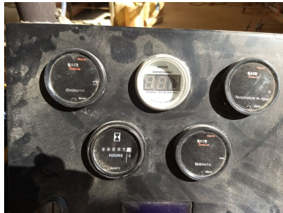
Figura 13 – Painel com informações sobre funcionamento do motogerador. Da esquerda para direita, acima, informações de rotação, relação ar e combustível e temperatura da água do radiador; abaixo, informações de tempo de funcionamento do motor e diferença de potencial na bateria
