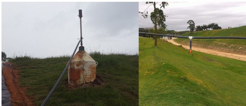
Figura 15 – Vista da campânula instalada sobre um dreno do aterro (à esquerda); Tubulação que leva o biogás do dreno ao motogerador (à direita).
