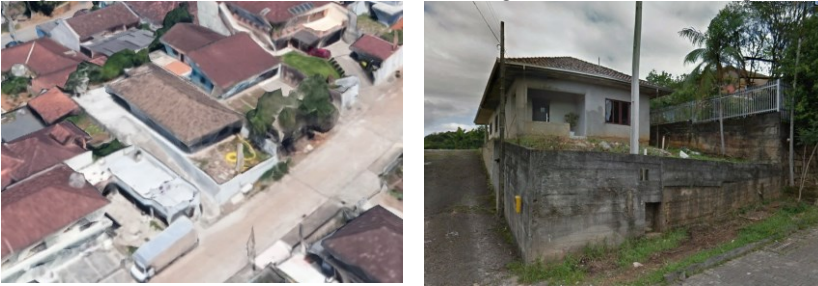
Figura 32 - Muro de arrimo de aterro sem drenagem e com armadura exposta.
