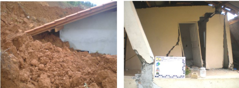
Figura 16 - Danos nas edificações, a esquerda soterramento, e a direita dano grave.
