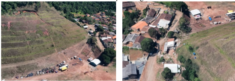
Figura 30 - Retaludamento com presença de degraus de abatimento e erosão, abaixo edificações irregulares.
