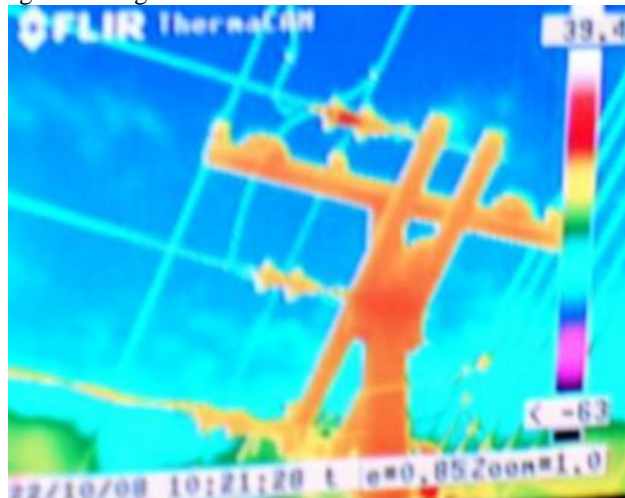
Figura 21: Imagem termográfica de cadeia de isoladores em uma linha de distribuição.
