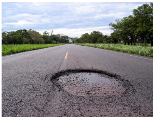
Figura 1.1: Exemplo de buraco em pavimento rodoviário.
