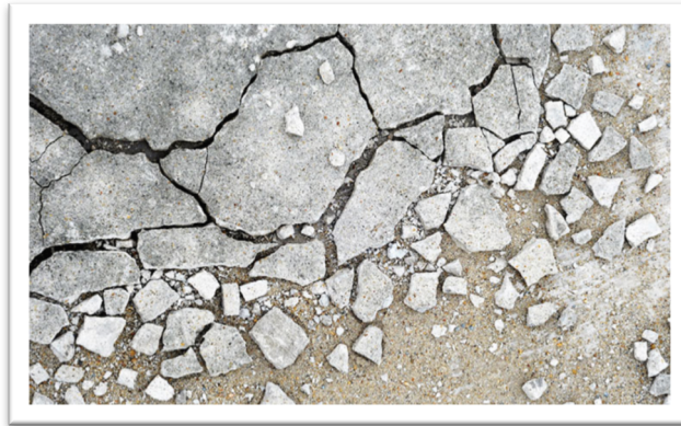
Figura 2.7 - Desagregação do contrapiso
