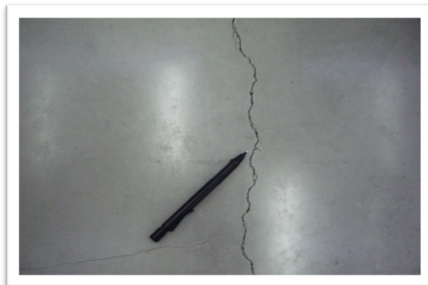
Figura 2.6 - Fissuras em toda a espessura do contrapiso
