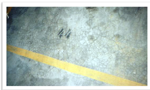
Figura 2.5 - Fissuras na camada superficial do contrapiso
