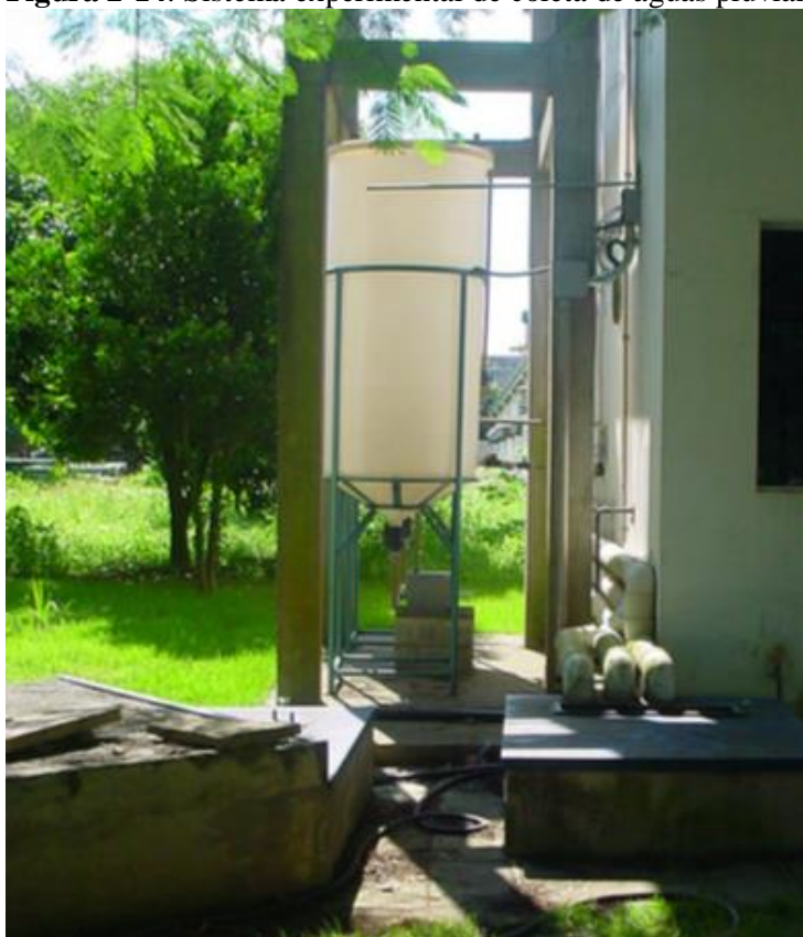
Figura 2-14: Sistema experimental de coleta de águas pluviais.
