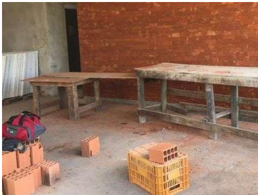
Figura 4-52 - Blocos armazenados de modo inapropriado.
