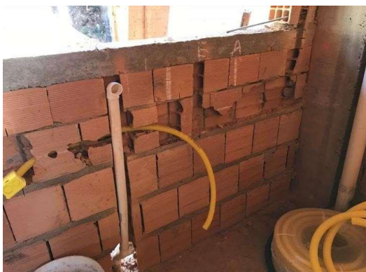
Figura 4-54 - Falta de planejamento na passagem das tubulações.
