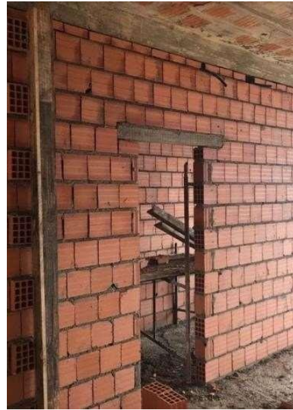
Figura 4-51 – Ausência de fixação entre alvenaria e viga.
