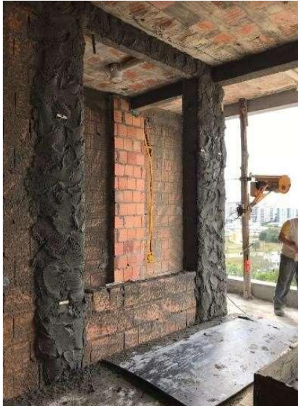
Figura 4-50 - Excesso de reboco para corrigir imperfeições.
