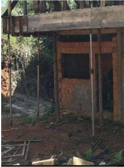
Figura 4-56 - Não execução de verga e contraverga nas portas e janelas.
