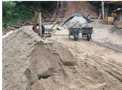
Figura 4-53 – Agregados armazenados de modo inapropriado.
