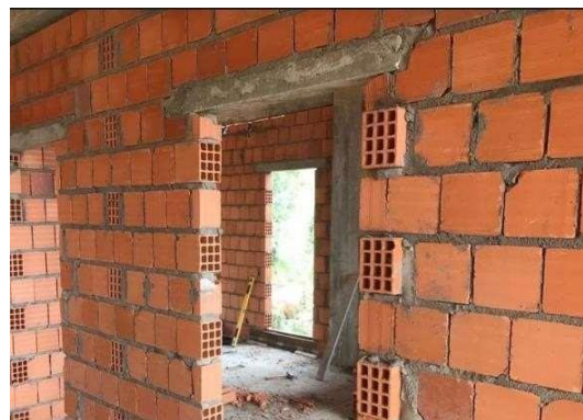
Figura 4-55 - Falta de modulação; blocos de baixa qualidade.
