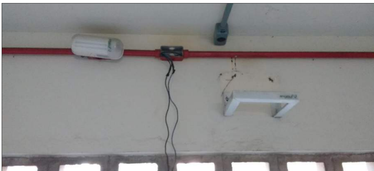
Figura 4.28 Placa luminosa desconectada do sistema centralizado.
