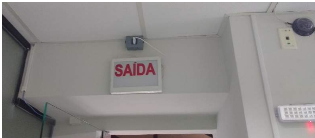
Figura 4.25 Placa luminosa instalada imediatamente sobre a porta.
