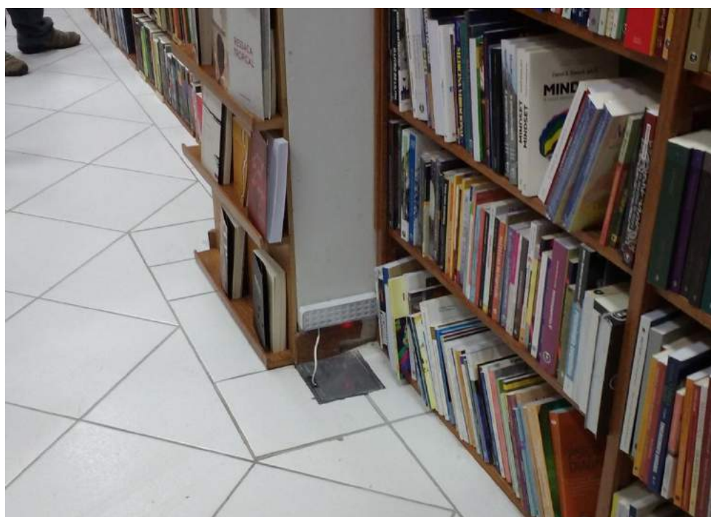
Figura 4.17 Local inadequado para instalação de bloco autônomo.
