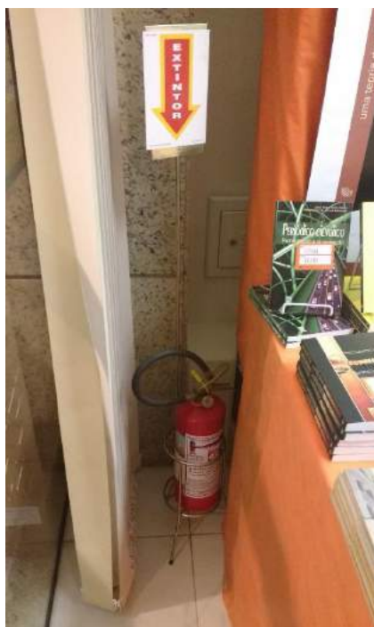
Figura 4.7 Extintor portátil em suporte sobre o piso.
