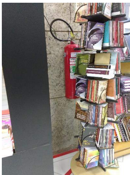
Figura 4.3 Extintor com baixa visibilidade e depósito de materiais.
