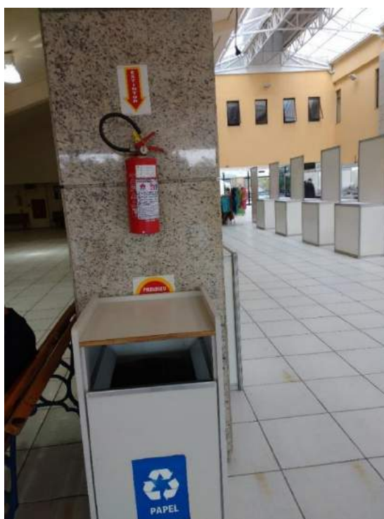
Figura 4.6 Extintor em coluna e com depósito de material.
