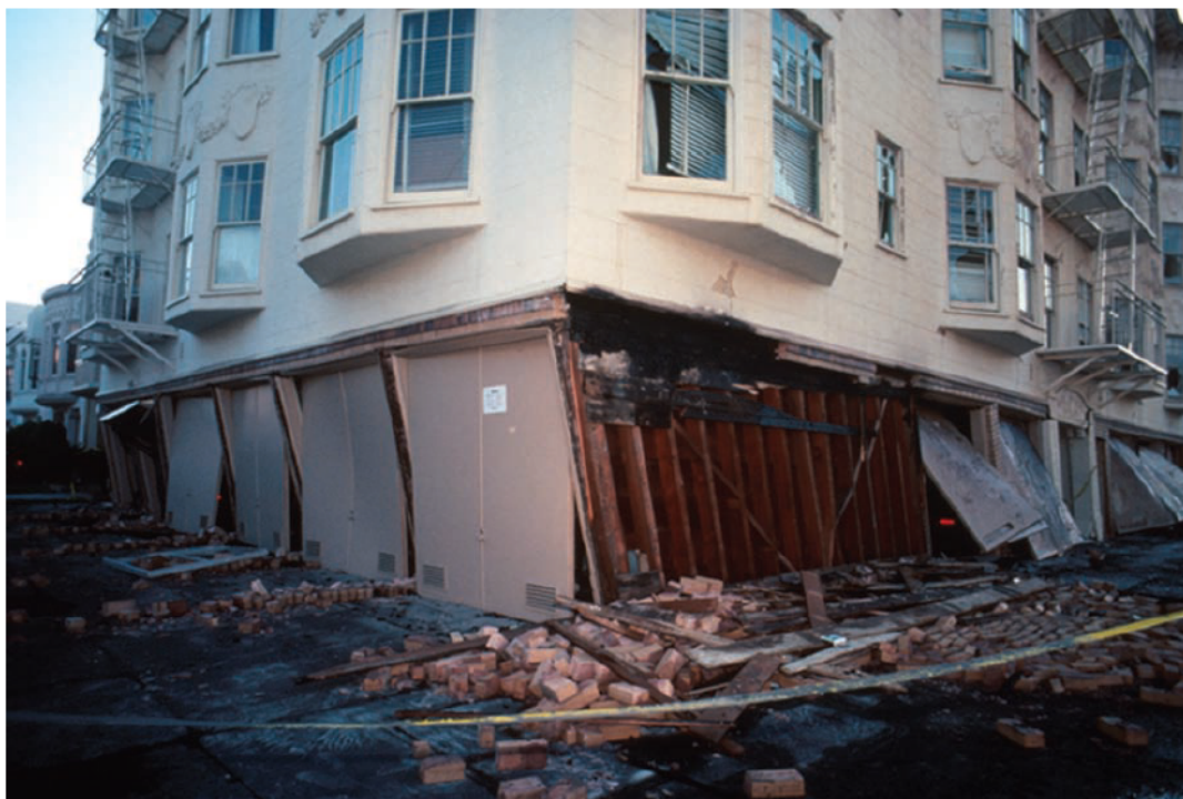
Figura 9 – Deformação por ausência de rigidez
