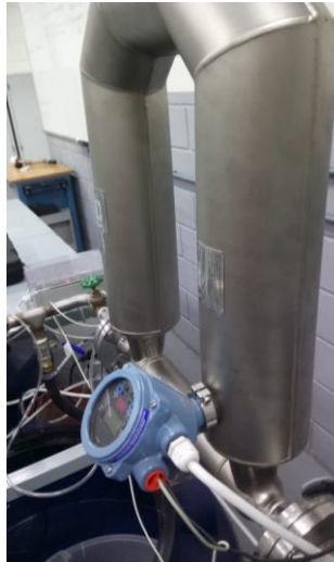
Figura 16 - Medidor de vazão Coriolis
