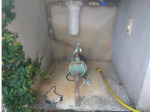
Figura 3.45 – Motobomba instalada na cisterna.
