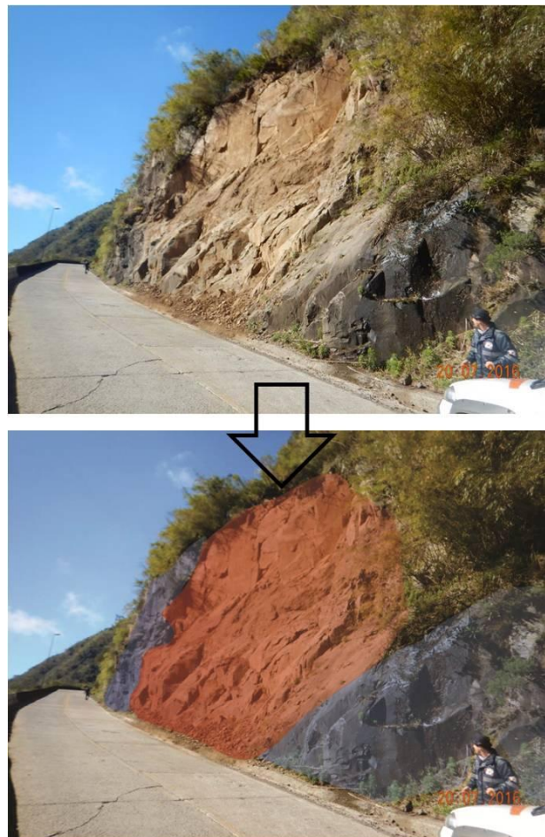
Figura 31. Talude Rochoso semivertical são (em azul) e rompido (em vermelho) à beira da SC-390, no km 407,56 (Governo de Santa Catarina, 2016 - modificado).
