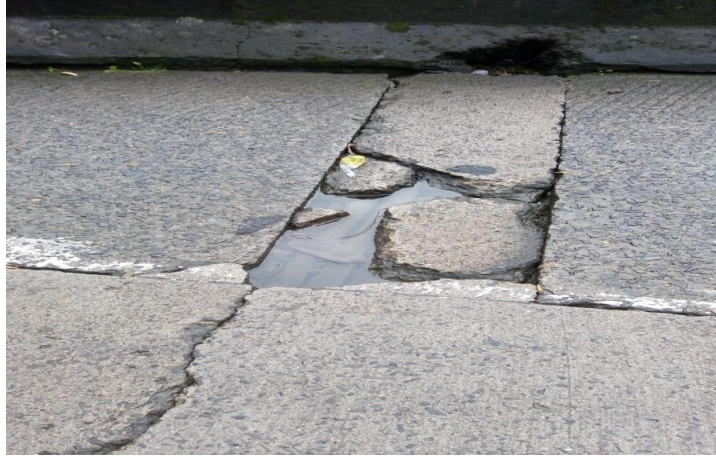
Figura 36. Rachadura preenchida por água na SC-390 acima do Talude da Área de Estudo. Foto: FLABOREA, 2017.
