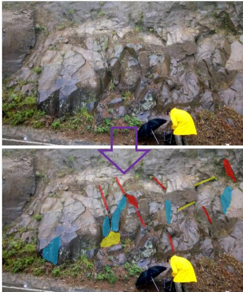
Figura 33. Sets de descontinuidades semiverticais com mergulho sentido NE (polígonos em azul), semiverticais com mergulho sentido NW (linhas e polígonos em vermelho) e semihorizontais com mergulho sentido NE (linhas e polígonos em amarelo) no talude são. Foto: CONCEIÇÃO, 2017.
