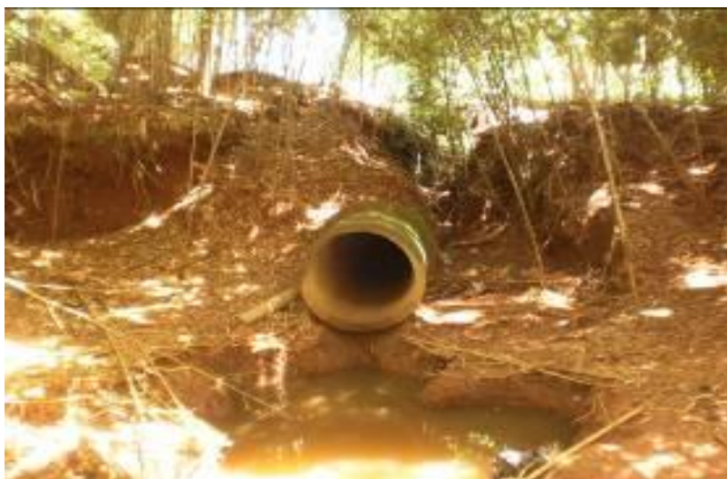
Foto 50: Erosão na margem direita do córrego Prosa no Parque das Nações Indígenas
