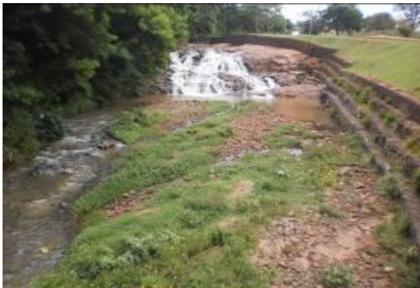
Foto 23: Acúmulo de sedimentos na Praça das Águas
