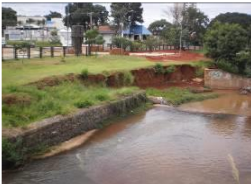
Foto 32: Erosão na margem esquerda do córrego Prosa
