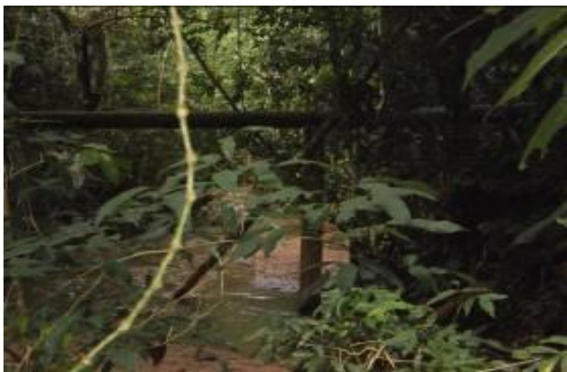
Foto 71: Duto de água sobre o córrego Prosa
