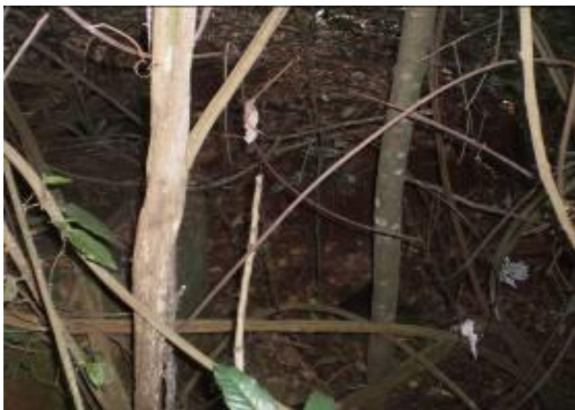
Foto 63: Erosão dentro do limite da APP
