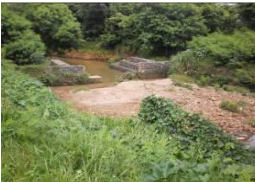
Foto 30: Barreira de retenção em gabião e acúmulo de sedimentos
