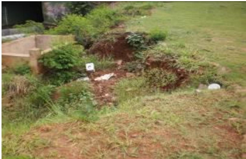
Foto 33: Erosão na margem esquerda do córrego Prosa
