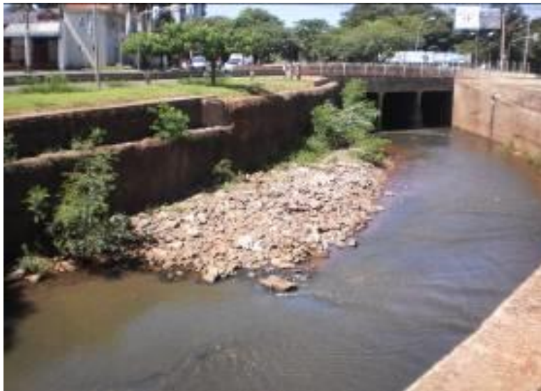
Foto 14: Resíduos sólidos no leito do córrego
