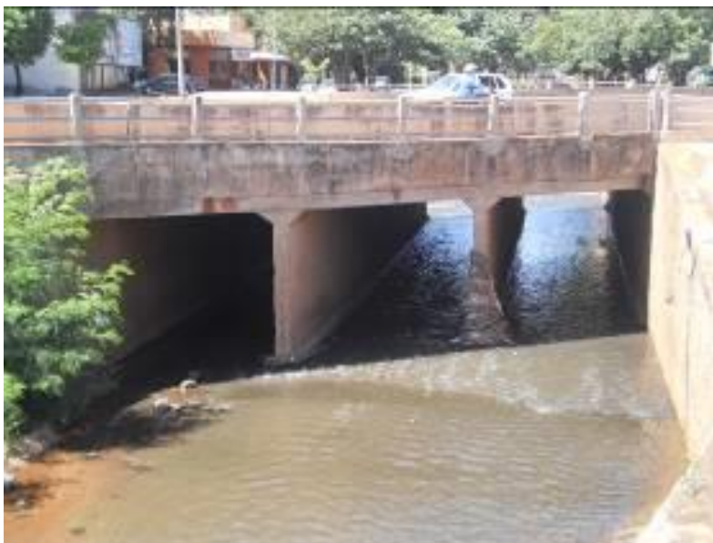
Foto 11: Ponte com pilastras e acúmulo de lixo e sedimentos
