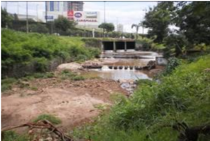
Foto 29: Acúmulo de sedimentos na Praça das Águas
