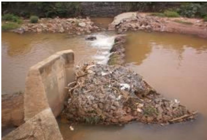
Foto 31: Barreira e resto de materiais de construção no leito do córrego Prosa
