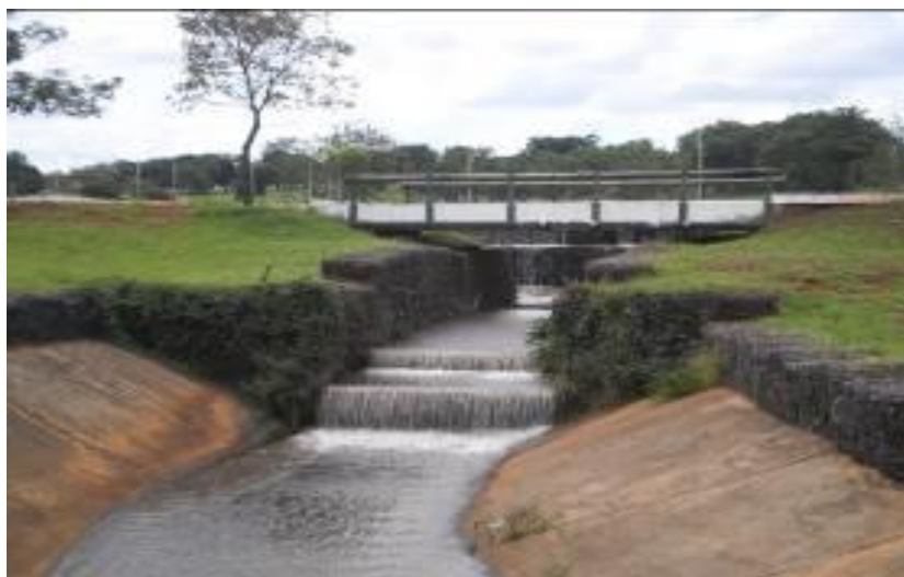
Foto 46: Córrego Prosa retificado e canalizado na saída do Parque das Nações Indígenas
