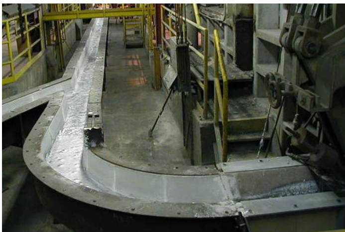
Figura 4 - Calha de transferência de alumínio líquido sem tampa ou sistema de aquecimento.
