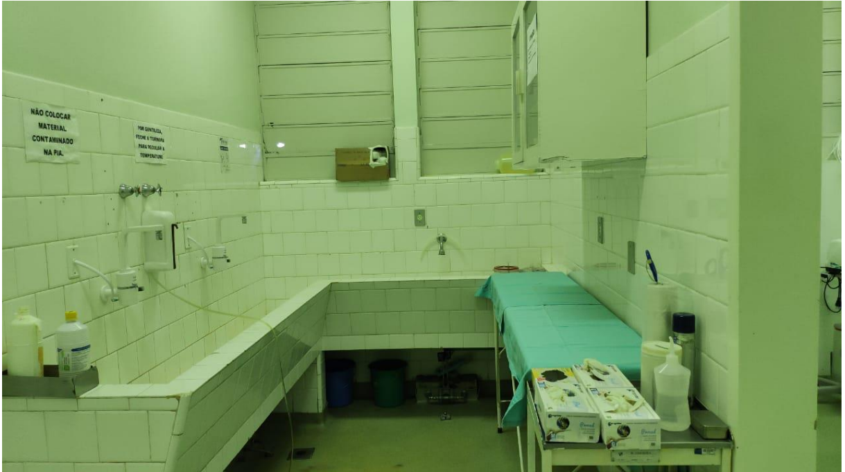
Figura 7 – Área para paramentação e antissepsia do bloco cirúrgico do Hospital Veterinário Universitário da Universidade Federal de Santa Maria. Santa Maria, 2018.
