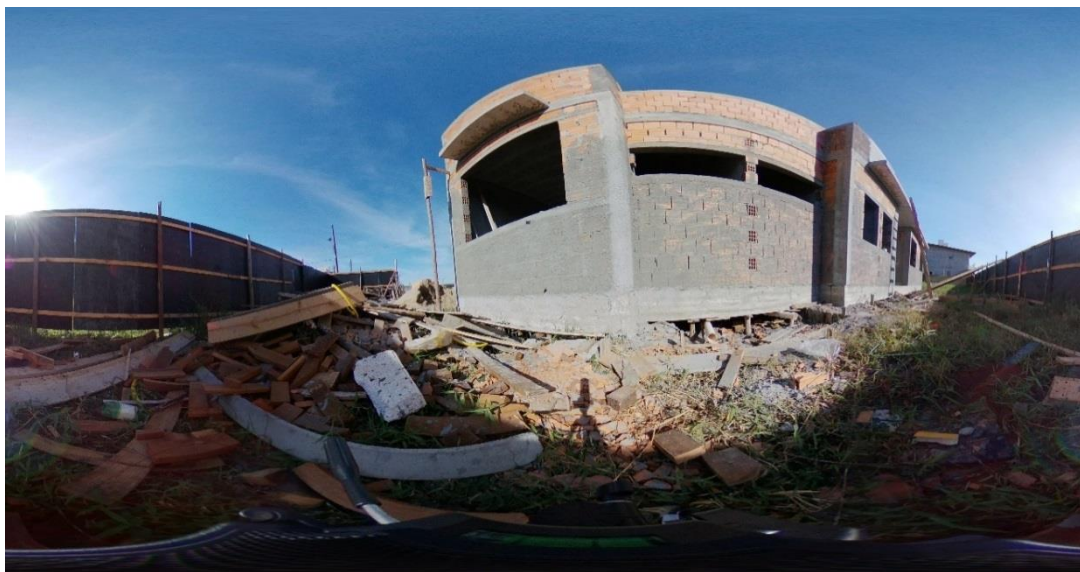
Figura 18 - Desperdício de material no entorno do terreno da obra
