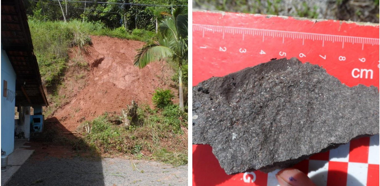
Figura 23: à esquerda, vista de um deslizamento em um talude artificial composto de arenito grosso, ao lado de uma casa (PNE001); à direita, amostra de arenito grosso (PNE010).
