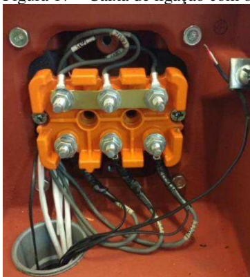
Figura 17 – Caixa de ligação com os sensores conectados do Motor 2.
