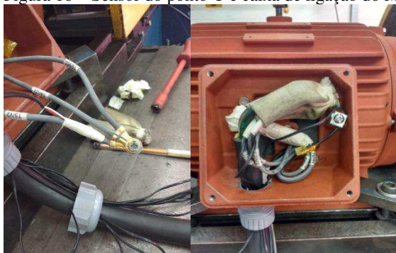
Figura 16 – Sensor do ponto Y e caixa de ligação do Motor 1.
