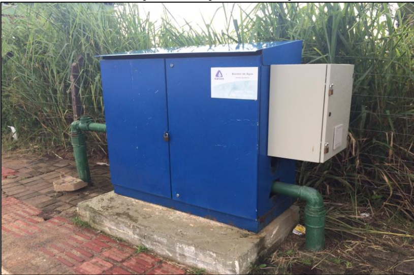
Figura 17 – Pressurizador de rede hidráulica para abastecimento de água no bairro da Tapera, município de Florianópolis, SC.
