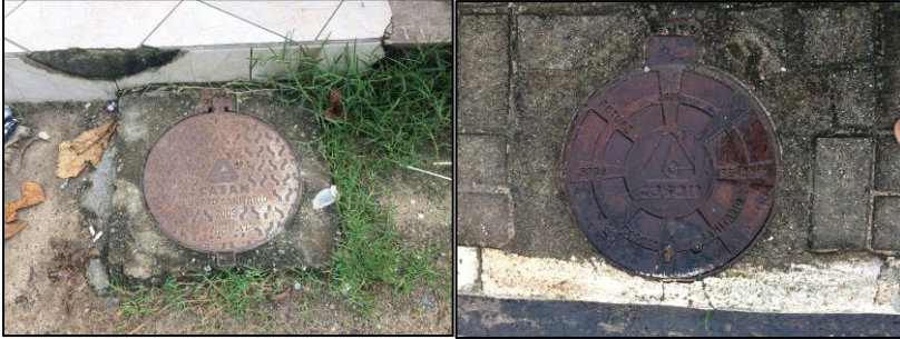
Figura 16 - Tampas referentes a suposto sistema de esgotamento sanitária no bairro da Tapera, município de Florianópolis, SC.
