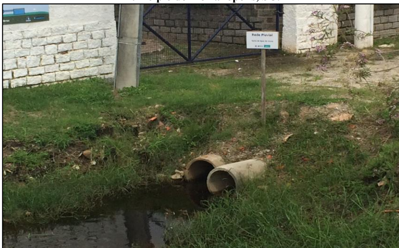
Figura 15 - Rede pluvial ligada ao rio do Braz no bairro de Canasvieiras, município de Florianópolis, SC.
