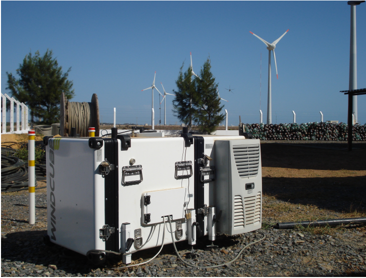
Figura 12 – Lidar instalado em Pedra do Sal.
