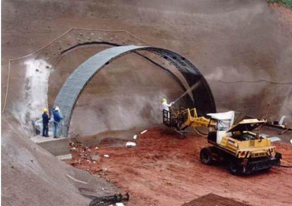
Figura 2.15 - Emboque com Portal em Concreto Projetado no Túnel de Rota Alternativa B27- Schürzeberg, Alemanha 1991
