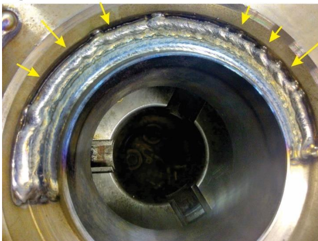
Figura 48 – Resultado da execução do procedimento na etapa 1. Em destaque (setas amarelas) a dificuldade encontrada para a fusão do material junto aos bordos do chanfro.
