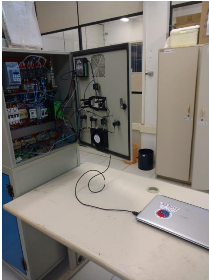
Figura 29 – Painel elétrico com os instrumentos conectados ao componente central de controle.
