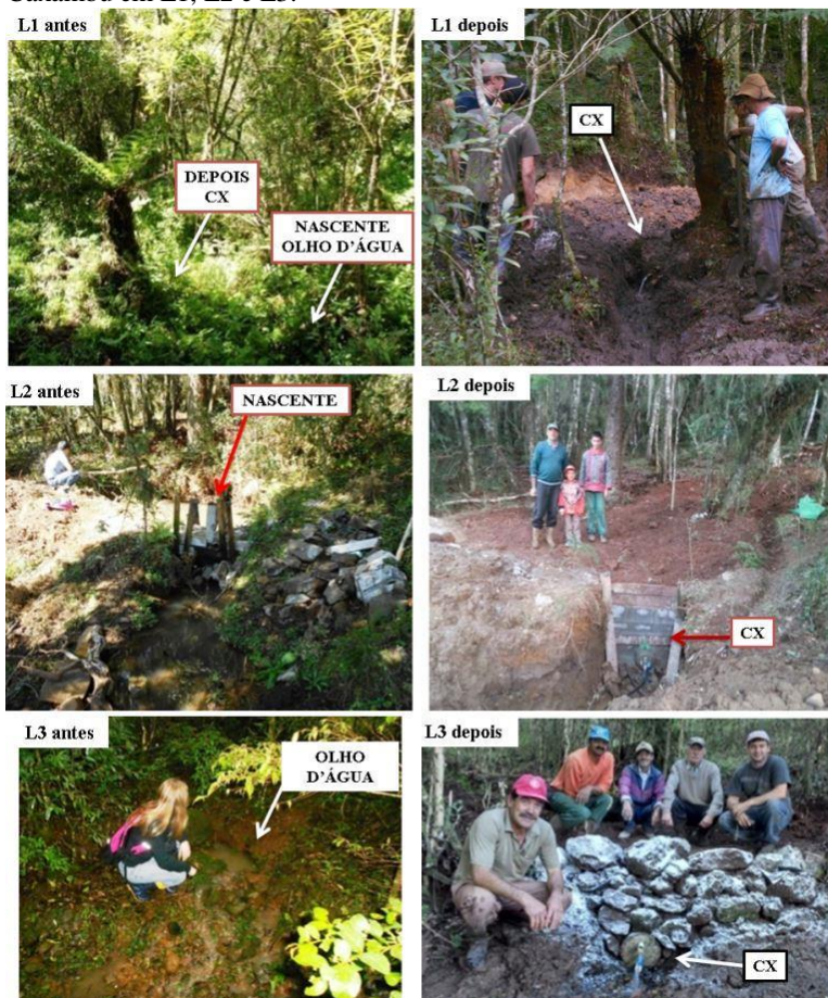
Figura 33 -Nascente antes e após implantação da proteção modelo Caxambu em L1, L2 e L3.
