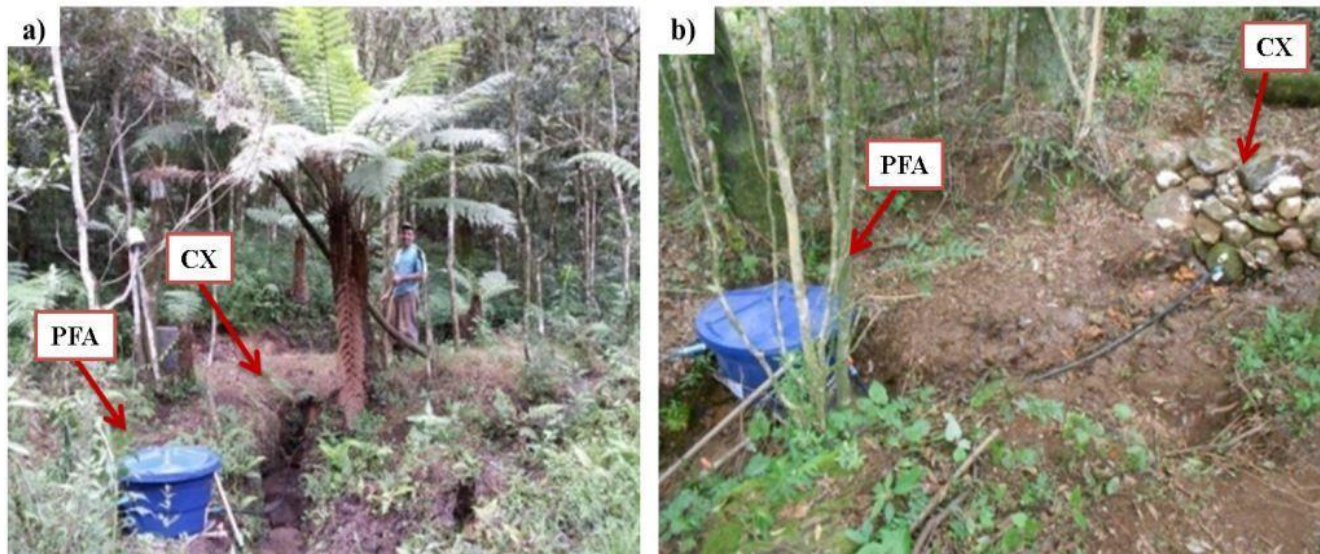
Figura 34 - Pré-filtro instalado à jusante da proteção de nascente; a) L1, b) L3.
