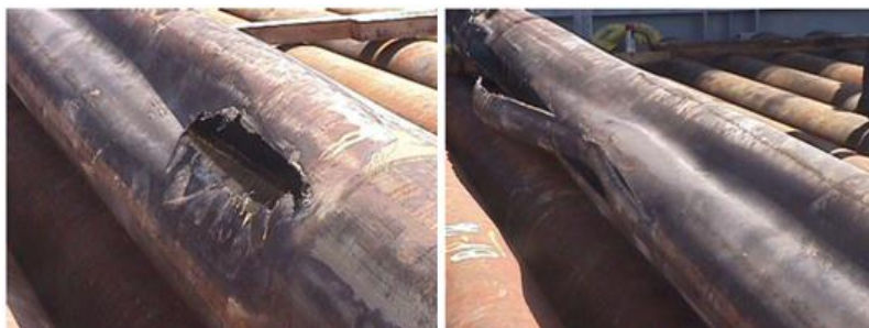
Figura 1.6 - Tubos de revestimento após ocorrência do colapso por APB (Pattillo et al. , 2006).
