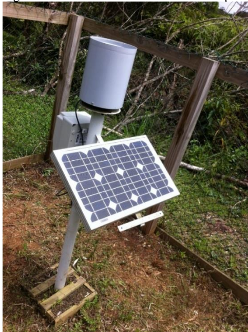
Figura 27 – Pluviômetro instalado em campo.
