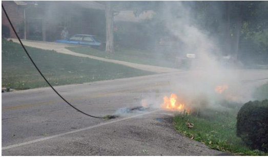
Figura 1 - Condutor rompido energizado em contato com asfalto (FAI).
