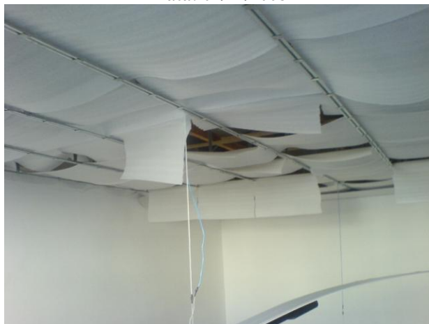
Figura 17 - Queda do forro da sala de Novos Talentos. O problema foi corrigido poucos dias depois. Data: 04/11/2008
