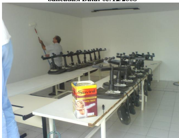
Figura 19 - Término da pintura interna da sala de novos talentos e instalação das cadeiras e bancadas. Data: 05/12/2008
