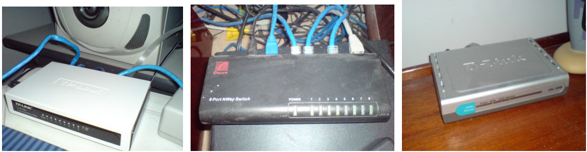
Figura 15 – Switch do Cluster, Switch da Rede Residencial e Modem Adsl
