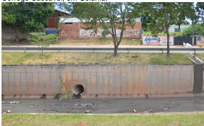
Figura 72: Curso d'água claramente poluído no trecho retificado do Córrego Cascavel, em Goiânia.
